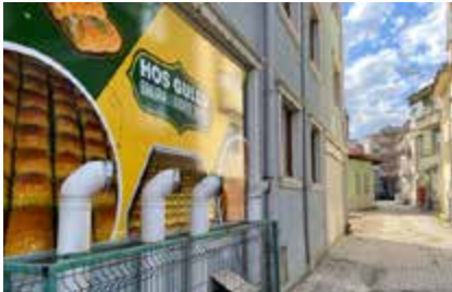
Havalandırma sisteminin yaya yolu yönünde bulunması
